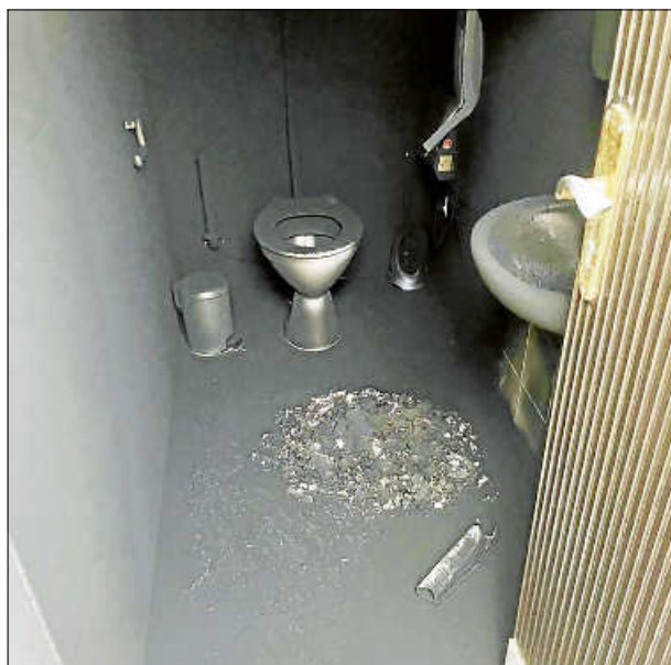
Durch einen Brand sind u. a. die Sanitäranlagen in der Aussegnungshalle beschädigt worden.
